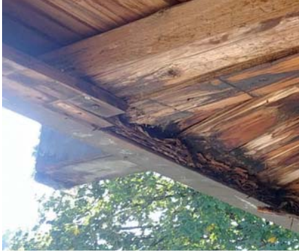
Typischer Wasserschaden vor und nach der Reparatur
